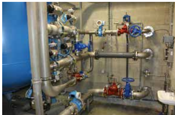
Exemple d'installation pour le traitement de l'eau
