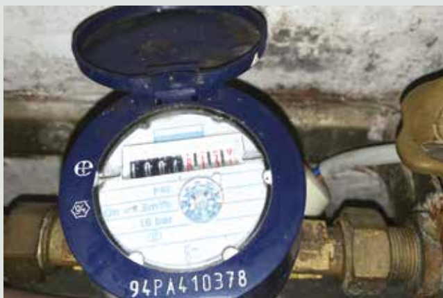
Exemple d'un ancien compteur d'eau
