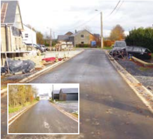
Nouvelle voirie et filets d'eau à Bernimont, la Hesse : réfection de la voie en mauvais état et réalisation de nouveaux filets d'eau.
